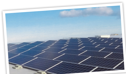
Upplands Energis SolElsanläggning på IFU Arena
